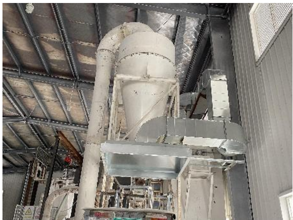
包装工序集气罩和收集管道
