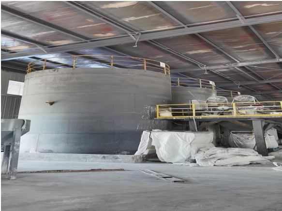
水玻璃储罐区
