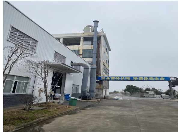
水喷淋塔+排气筒
